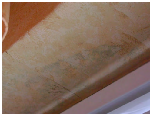
Abb. 3: Geringe Absorption von Feuchtigkeit an Bauteiloberfläche an Wärmebrücke
