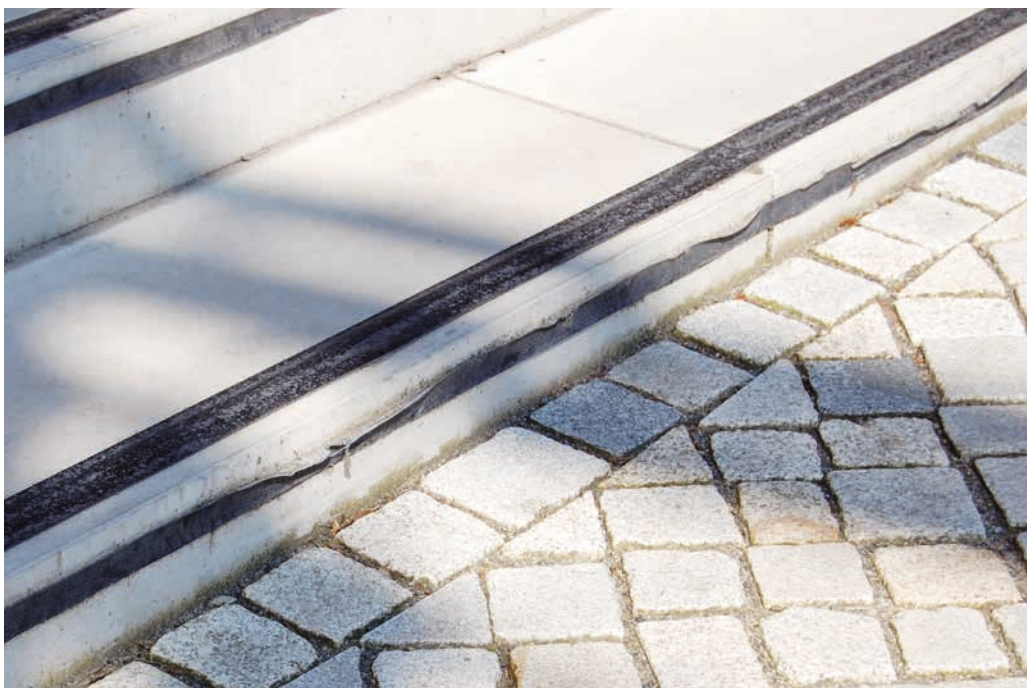
Abb. C 1.33: Ablösung einer nachgerüsteten, nicht dauerhaft haltbaren Stufenmarkierung im Detail
