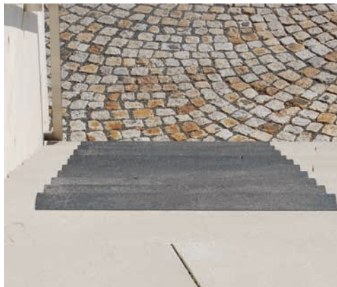
Abb. C 1.37: Betontreppe mit nachträglich auf die Trittstufe geklebter Stufenmarkierung – Die Stufenkanten als solche sind nicht erkennbar.
