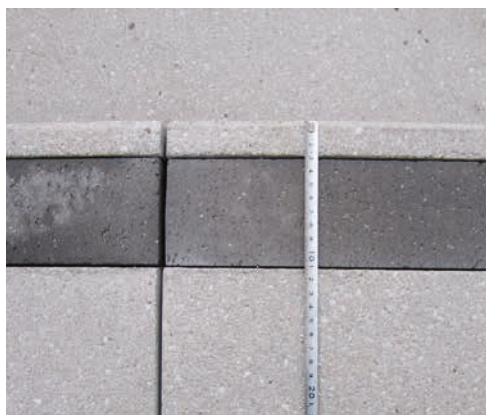
Abb. C 1.39: Treppe mit nachträglich eingelegter Stufenmarkierung in die Trittstufe
