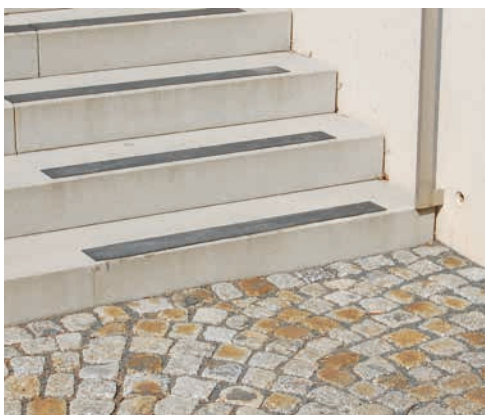
Abb. C 1.38: Treppe mit nachträglich aufgeklebter Stufenmarkierung
